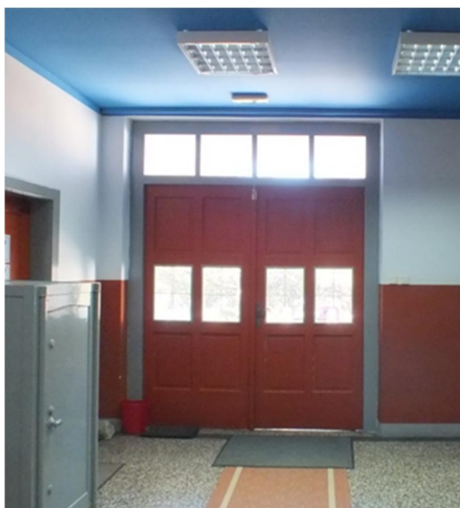
Ilustracija 68 – Postojeća ulazna vrata s manjkavom izolacijom
